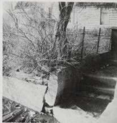
De ontzette voetingmuur van het hek om de pastorietaan.
